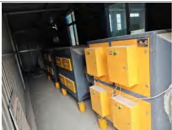
油烟净化器+二级活性炭吸附装置
