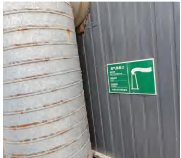
排气筒 DA002 标识牌
