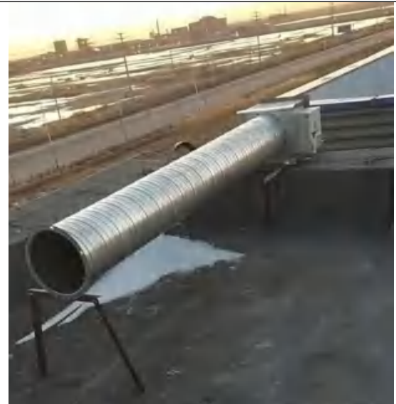
烟净化器排气管道
