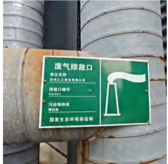
排气筒 DA001 标识牌
