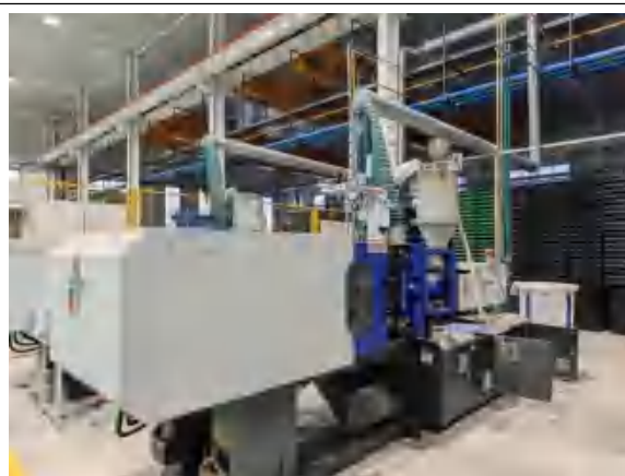
注塑机集气管道
